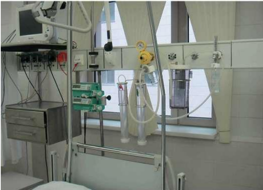
Рис. 1.4. Подводка сжатых газов и электропитания к реанимационной койке
